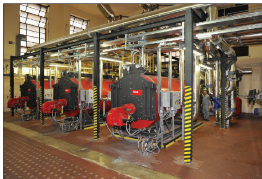
Il locale caldaie della centrale elettrica vaticana
